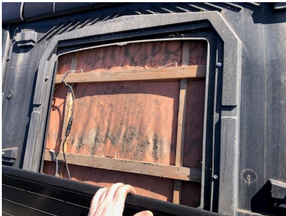
Geen brandwerend doek, onvoldoende afstand tussen het paneel, doek, isolatie, hout en de connectoren en de kabels zijn niet aangelegd conform de norm.
