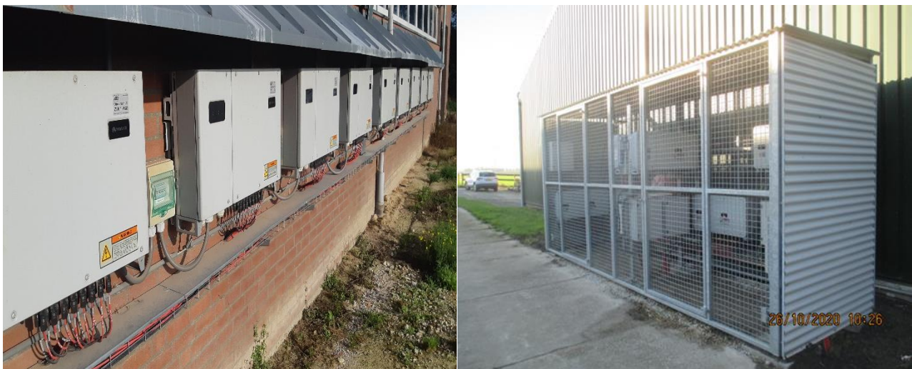
Buiten geplaatste omvormers Bron : Achmea/SOBH
