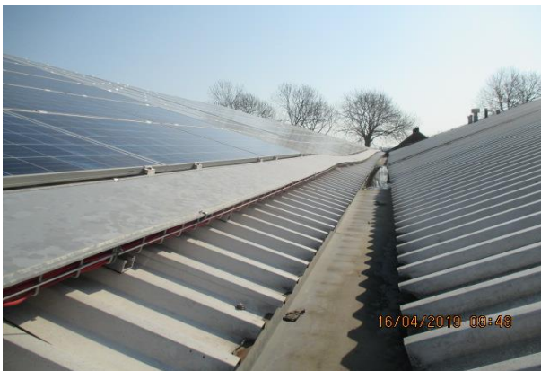
Doorzakken van het dak
