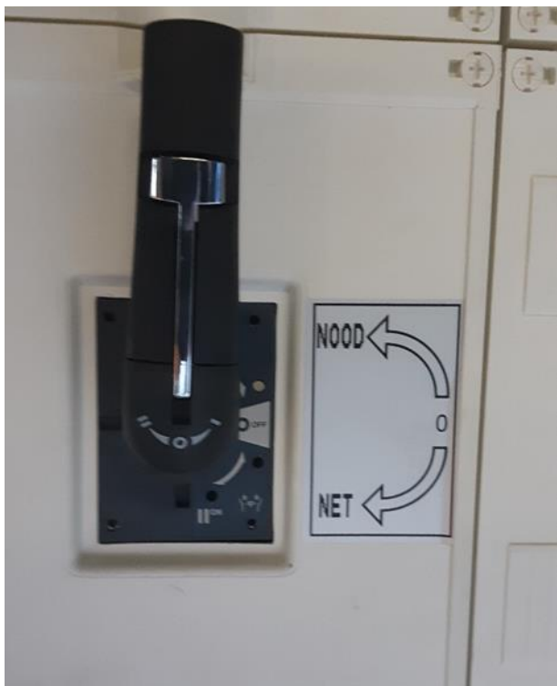
Schakelingnoodstroom Bron: Achmea
