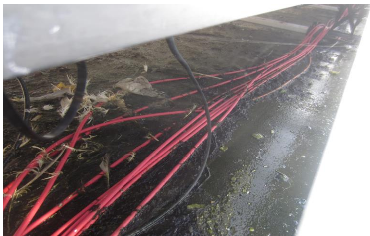
Kabels op dak en vervuiling
