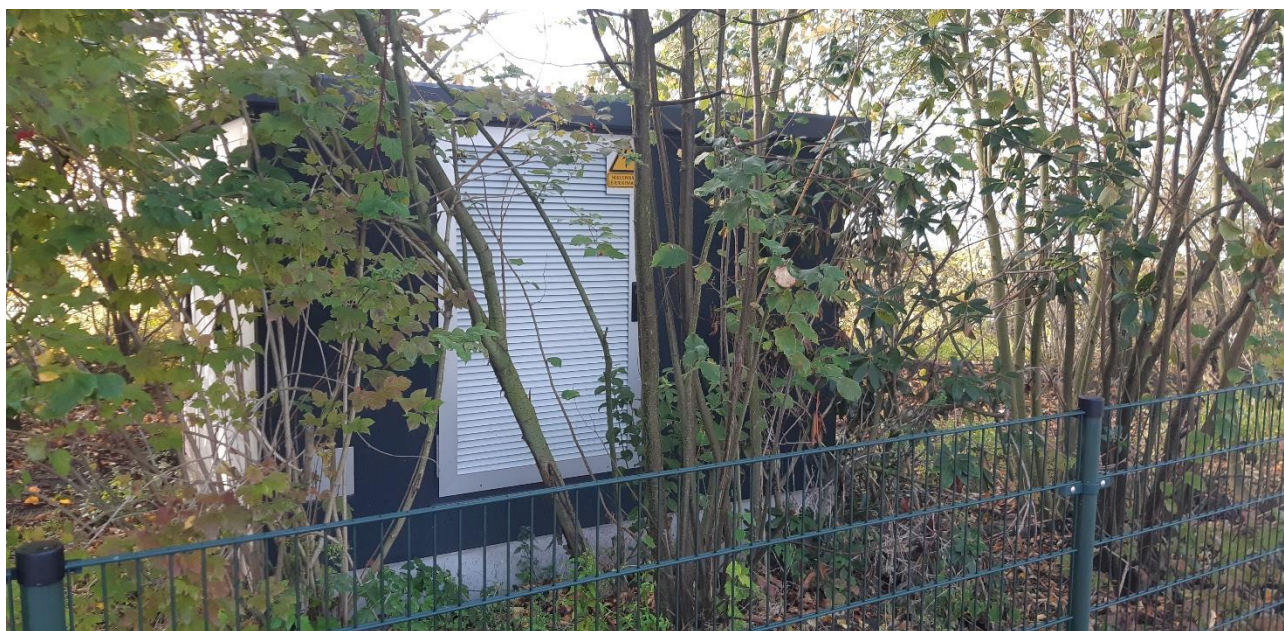
Transformator tussen begroeiing. Belemmering koeling en blussen.
